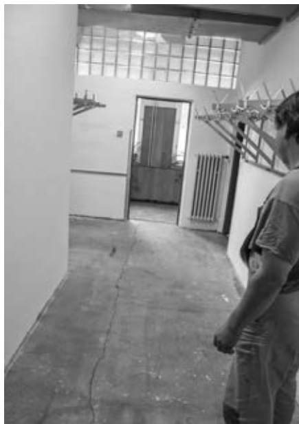
Malá šatna před opravou podlahy
